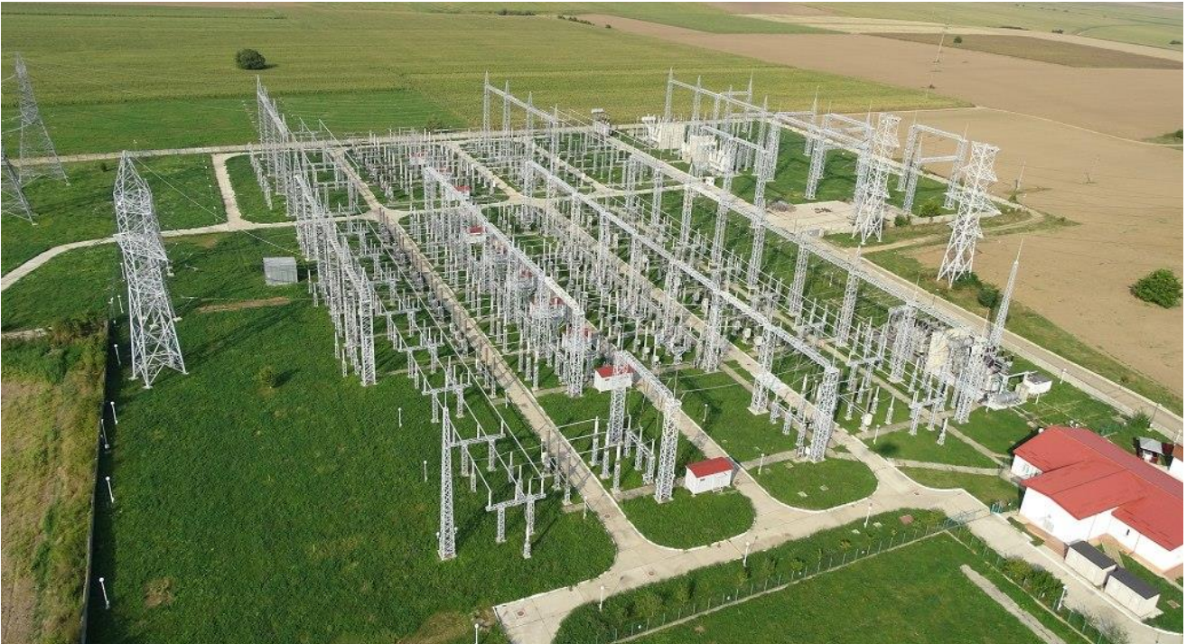
Foto: Stația 400/220/110 kV Gutinaș
