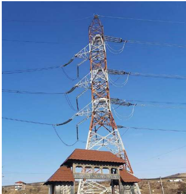
Foto: Stația Electrică de Transformare 400/110/10 kV Cluj Est
