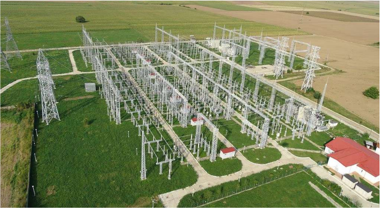
Foto: Stația 400/220/110 kV Gutinaș
