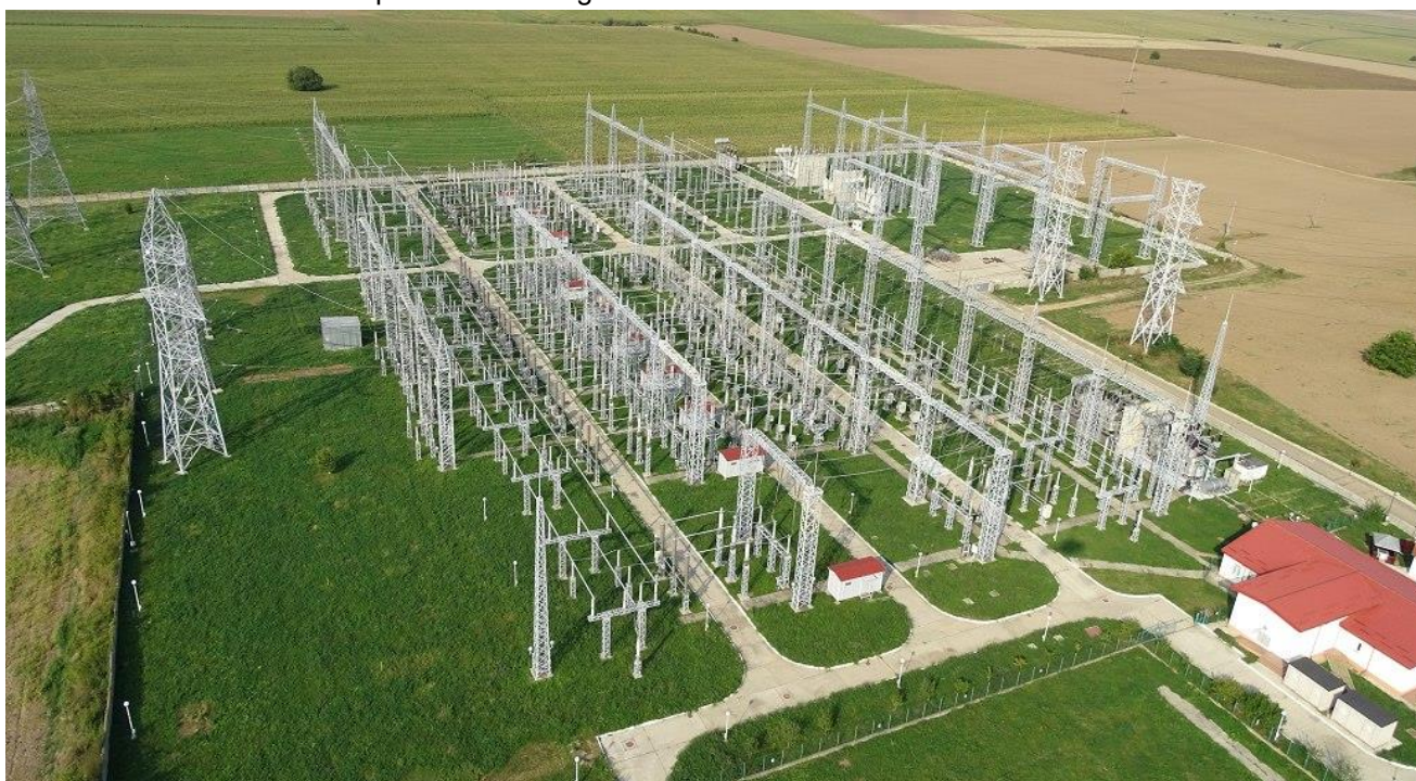
Foto: Stația 400/220/110 kV Gutinaș
