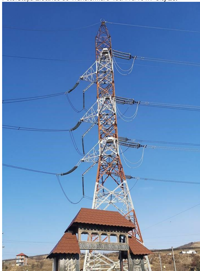
Foto: Stația Electrică de Transformare 400/110/10 kV Cluj Est
