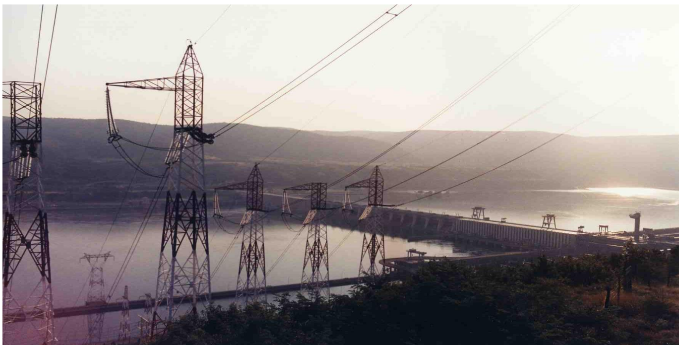
Foto:Prima arteră de 400kV din Sistemul Energetic Național–Linia Electrică Aeriană 400kV, simplu circuit,CHE Porțile de Fier – București Sud
